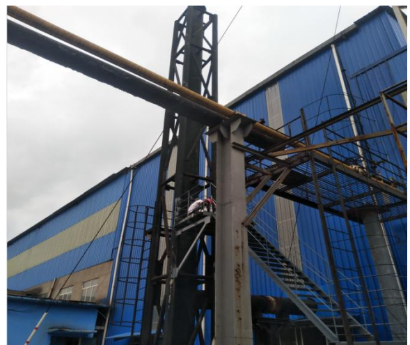
热处理废气排气筒
