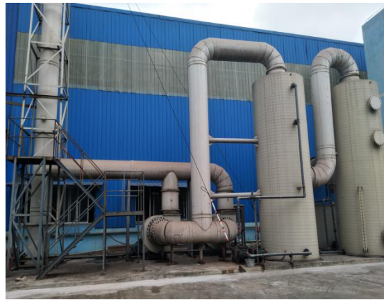
铅浴炉废气处理设施及排气筒
