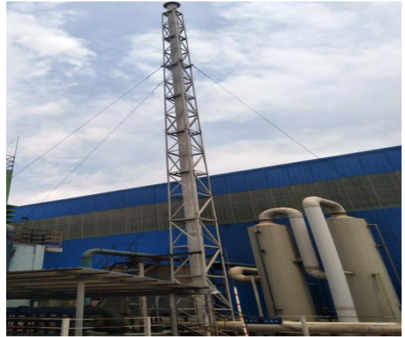
酸洗废气处理设施及排气筒
