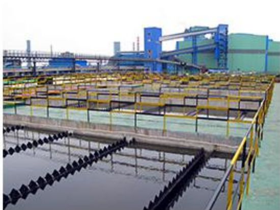
2号污水处理站
