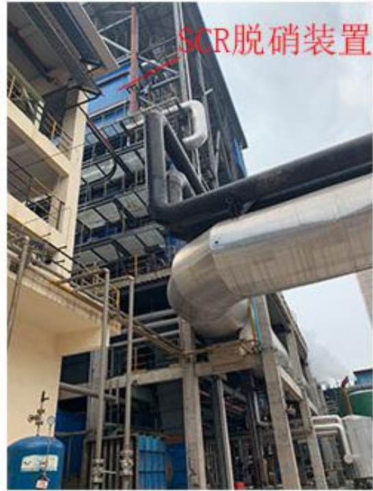
SCR脱硝装置
