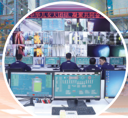
热电站集控室
