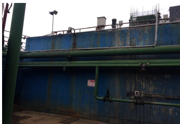
项目新增反应池
