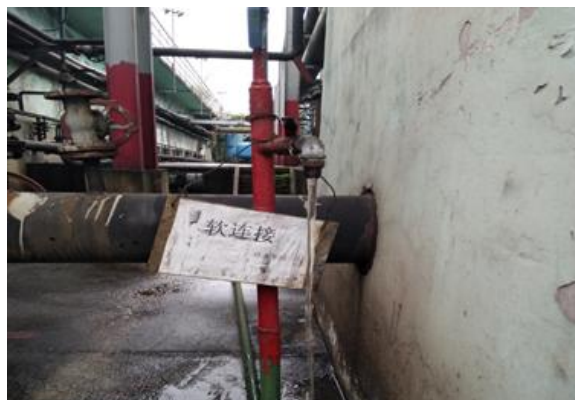
项目废水取水点
