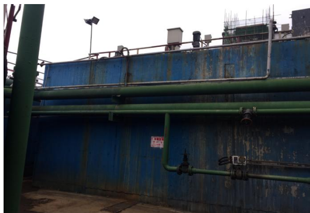
项目新增反应池
